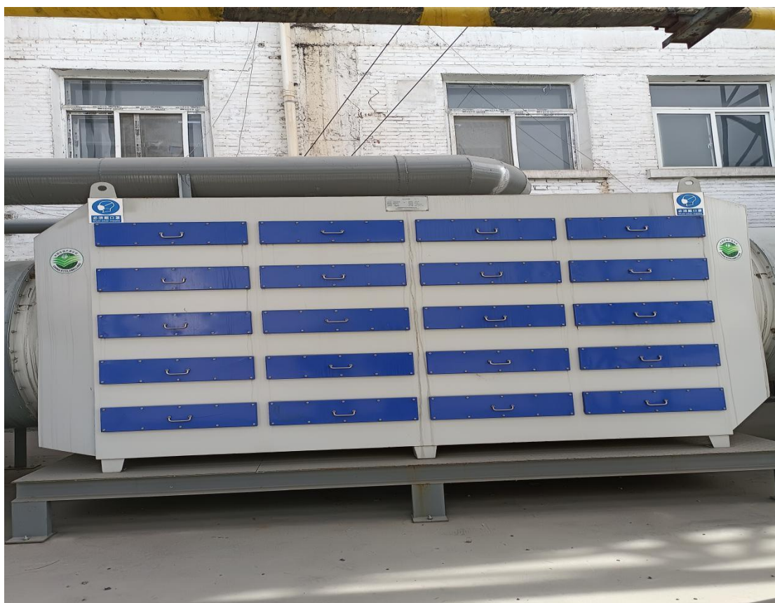
图 4-2 粉体分厂活性炭过滤箱
