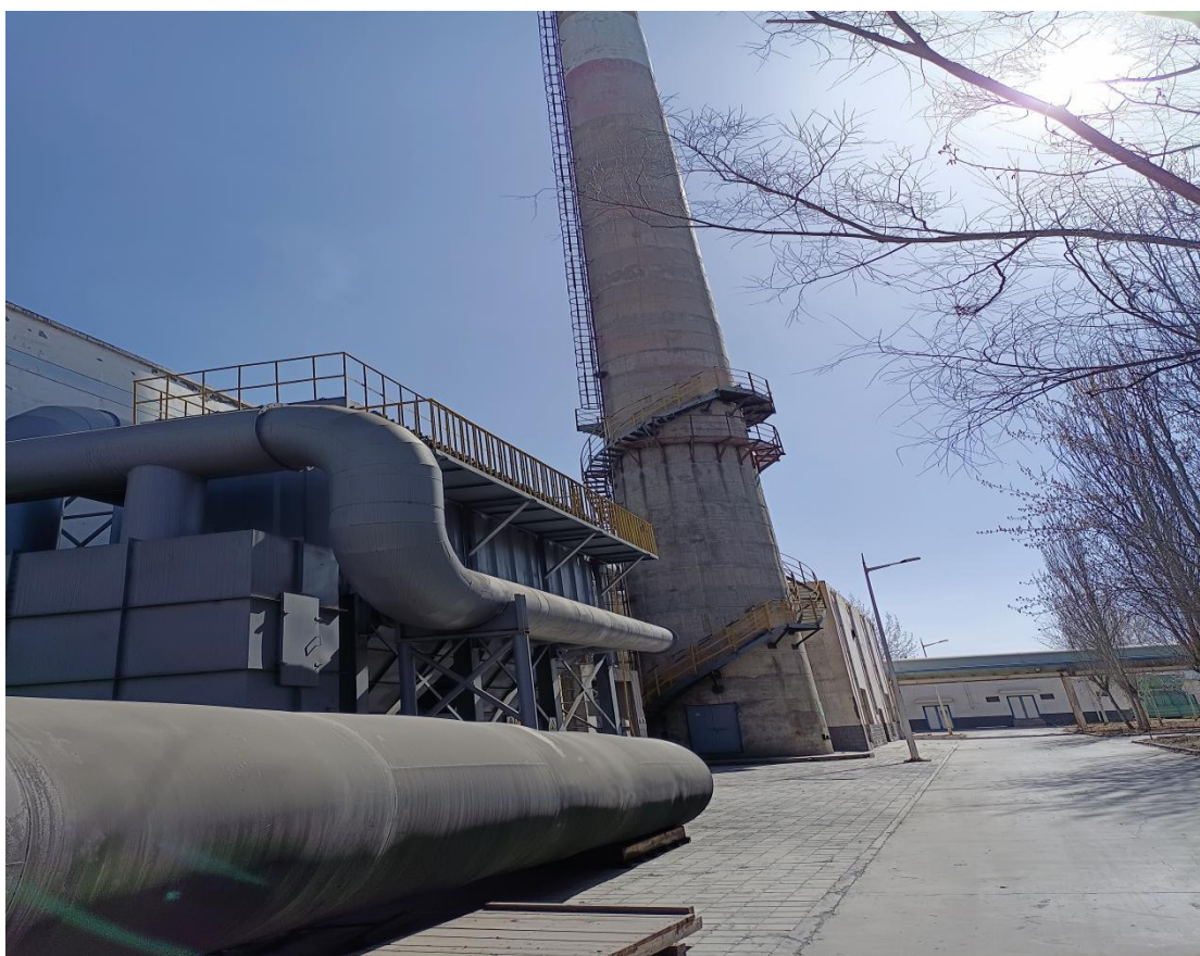
图 4-8 铍铜分厂新熔铸车间 60 米排气筒
