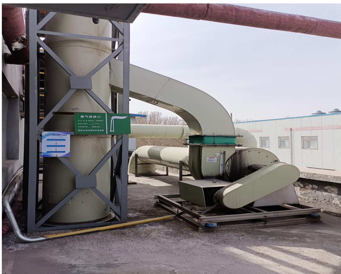
图 4-4 银粉生产线 18 米排气筒
