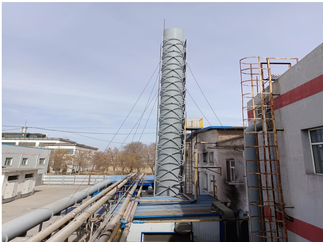
图 4-5 银浆（膏）生产线 25 米排气筒
