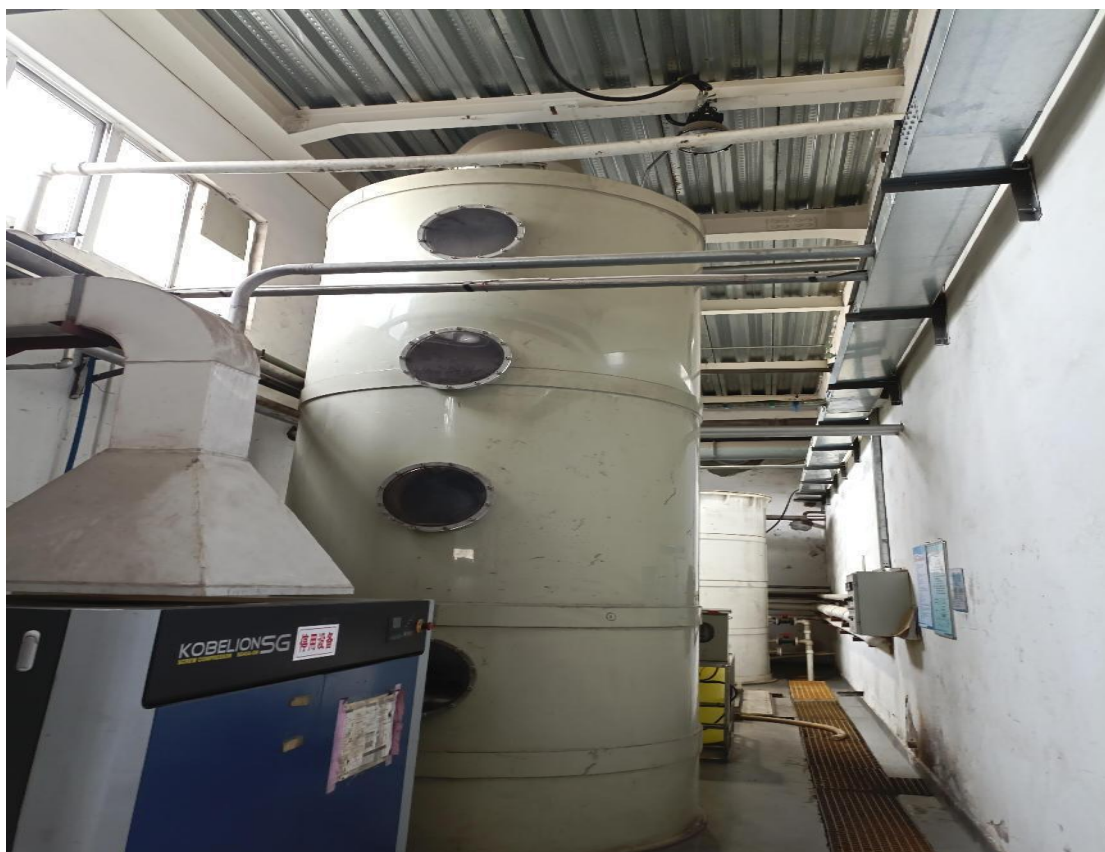
图 4-3 粉体分厂碱液吸收塔
