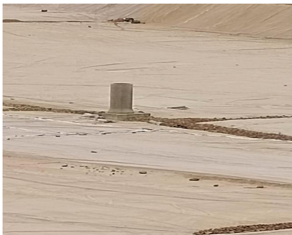
图 4-10 渗滤液提升井
