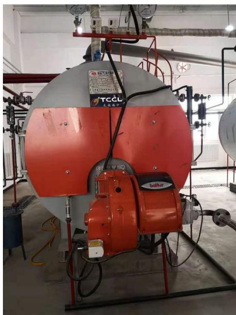
图 4-4 低氮燃烧工艺锅炉
