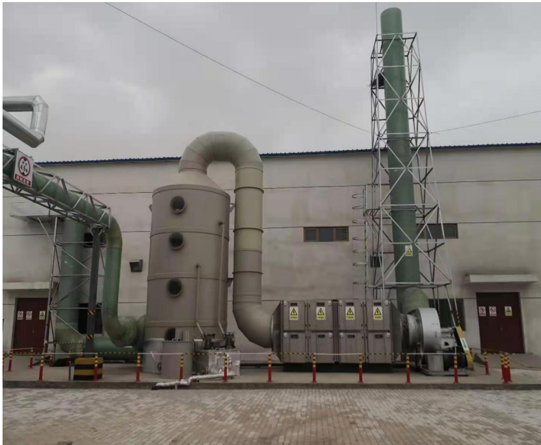
图 4-2 空气净化系统（碱性洗涤塔+UV 光解+15m 高排气筒）
