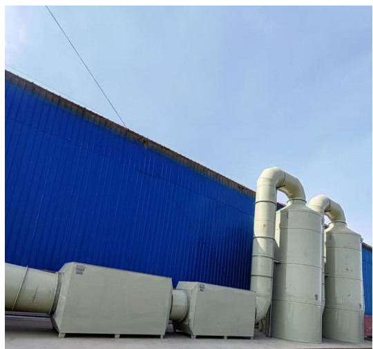
二级碱洗喷淋塔+二级活性炭箱吸附
