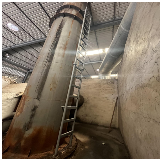
生产车间旋风除尘器
