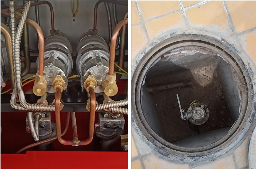
图 3-4 油气回收装置
