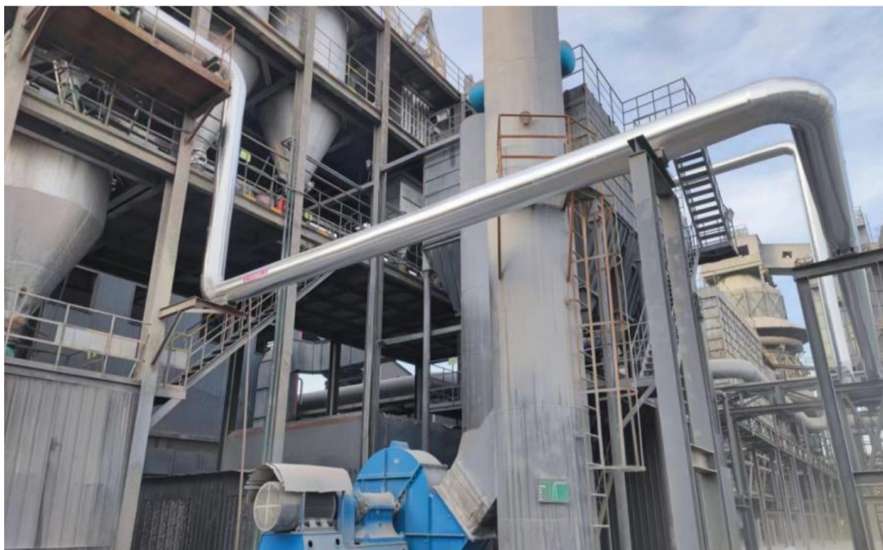
图 5-10 4#电石炉净化系统及出炉除尘
