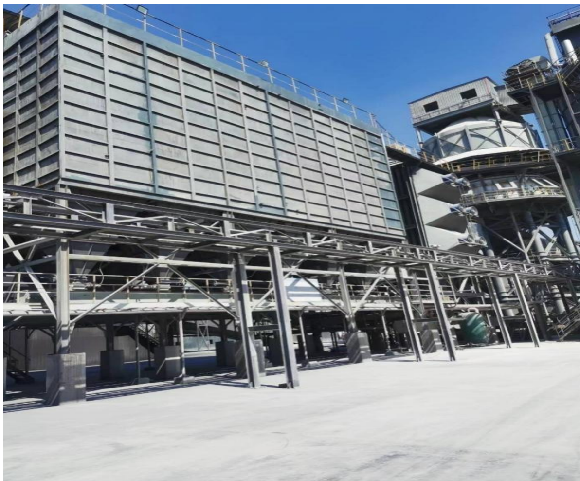
图 5-1 石灰窑旋风除尘器+高效布袋除尘器
