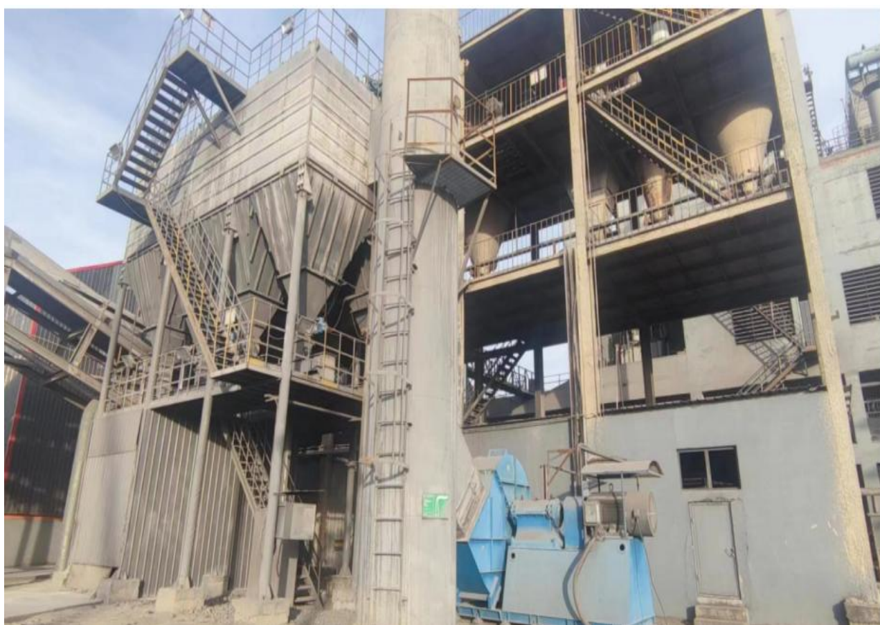
图 5-8 3#电石炉净化系统及出炉除尘
