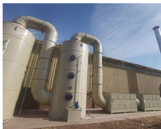
二级碱洗喷淋塔+二级活性炭箱吸附
