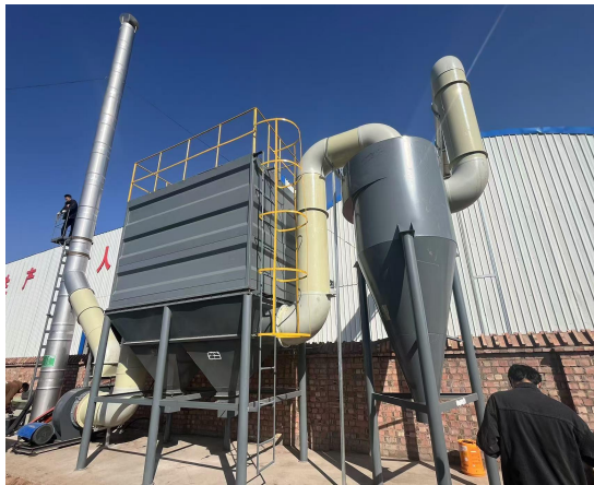
生产车间旋风除尘器
